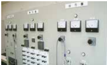
▲模擬送電線装置
