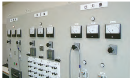
▲模擬送電線装置
