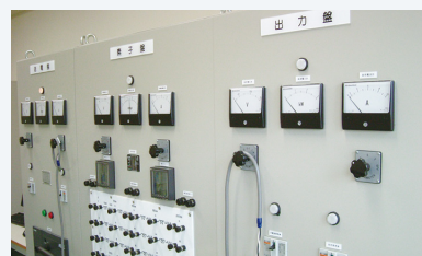
▲模擬送電線装置
