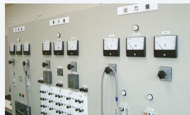
▲模擬送電線装置
