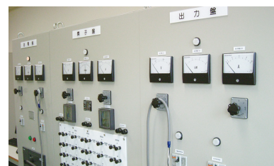
▲模擬送電線装置
